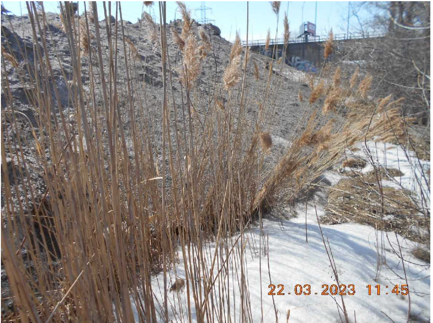
DSCN4124.JPG Image 5. Fossé non-entretenu (végétation) et accumulation de neige dans le fossé
