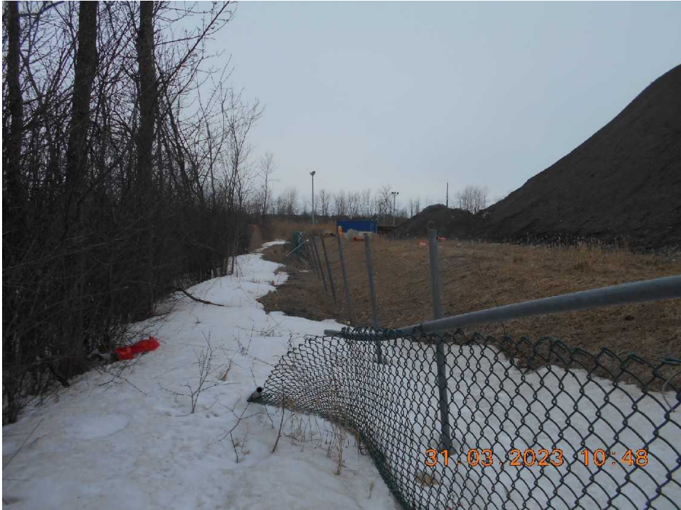
DSCN4161.JPG Image 10. Clôture endommagée, fossé sud
