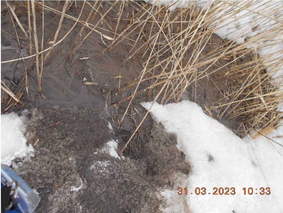
DSCN4148.JPG Image 4. Le fossé est envahi par la végétation et non-profilé
