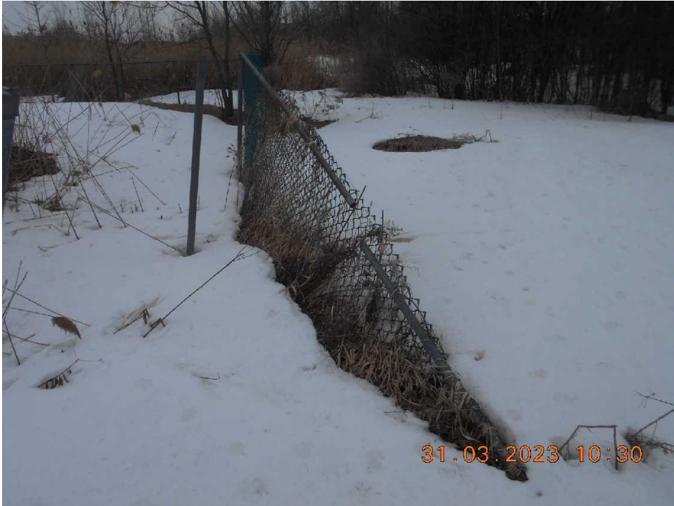
DSCN4145.JPG Image 1. Clôture endommagée coin fossé sud / fossé ouest
