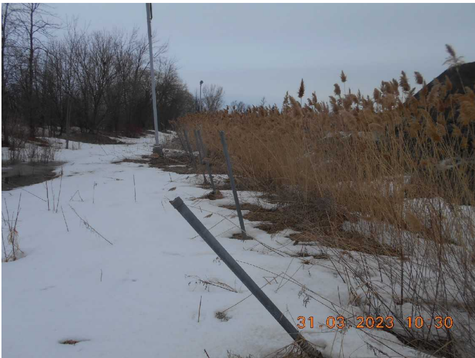
DSCN4146.JPG Image 2. Clôture endommagée, fossé ouest
